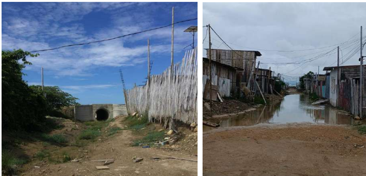
Ilustración 40 Alcantarilla en el paso lateral y agua acumulada por las lluvias.
